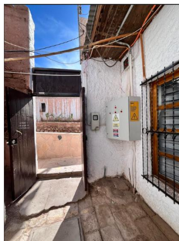
Imagen N° 04 y 05: Referencias corte energía eléctrica general.
