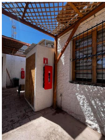
Nº 3: Data Center – TIC.
